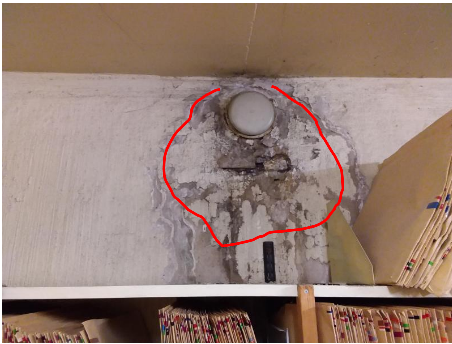
Betonirakenteinen ulkoseinä on kosteaa iv-venttiin ympäriltä Gann 86-106.
